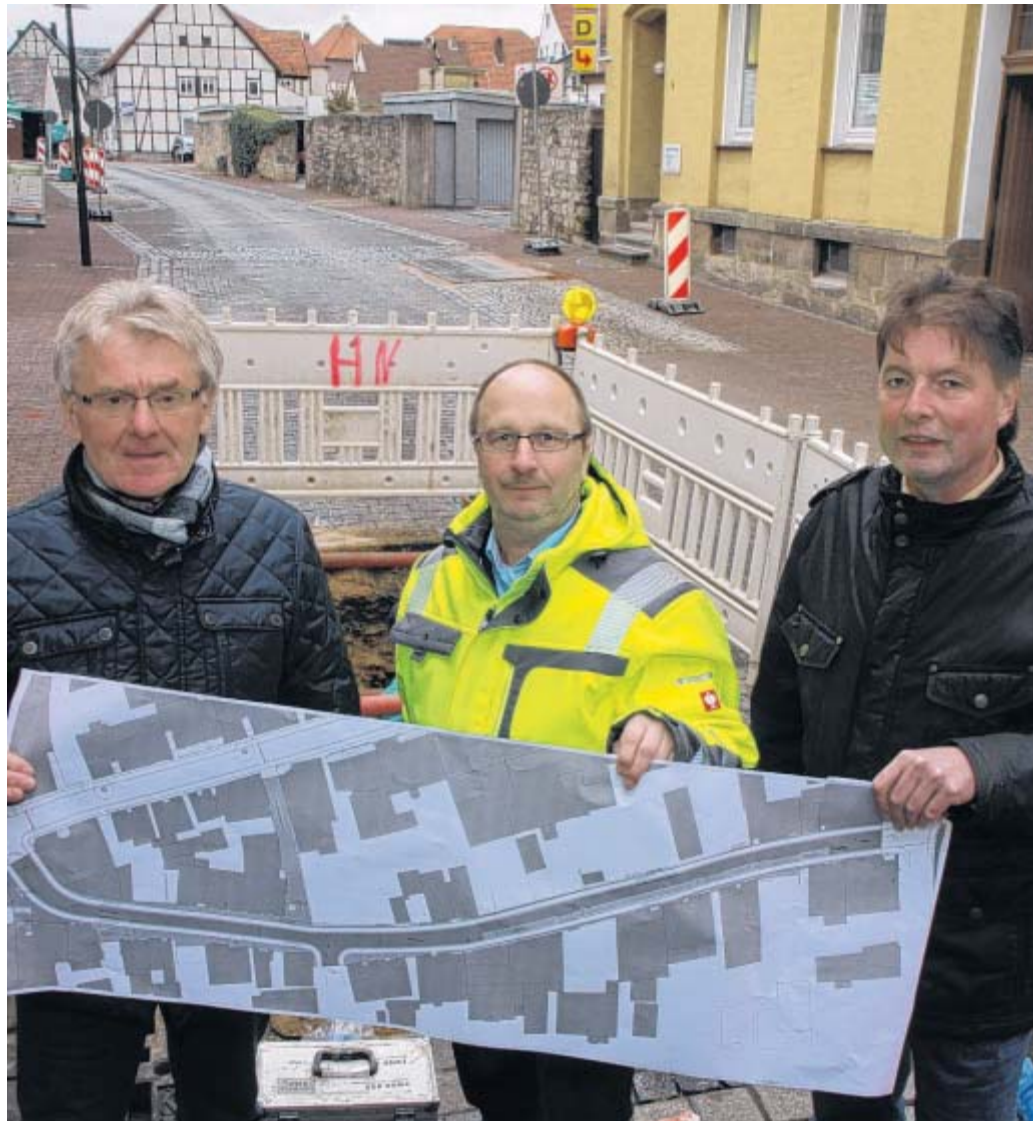
Wasserleitungen sind verlegt: Bauamtsleiter Walter Güntermann (v. l.), Helmut Schmitz, Technischer Leiter der Stadtwerke, und Andreas Scholle, Leiter des Ordnungsamtes, informieren über den fünften Abschnitt des barrierefreien Umbaus der Innenstadt. In der Josef-Wirmer-Straße sind im Tiefspülverfahren Wasserleitungen verlegt worden.
